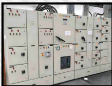
Low tension Panel(LTP)
